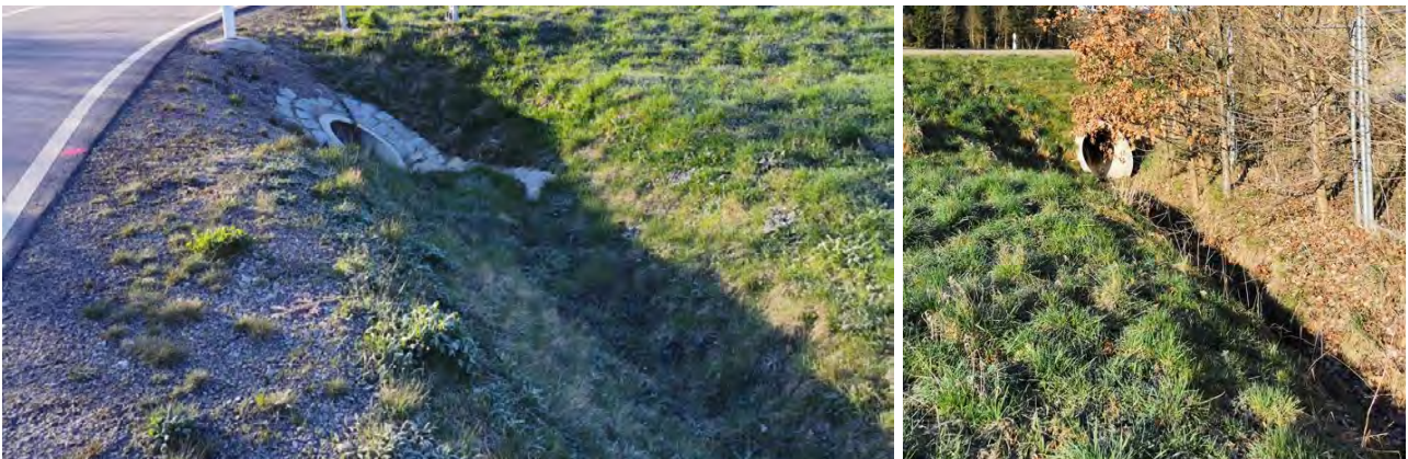
Abb. 25: Trockengefallener Entwässerungsgraben im Plangebiet. Links: im Südosten entlang der Haigerlocher Straße; rechts: im Westen entlang der Baumhecke
